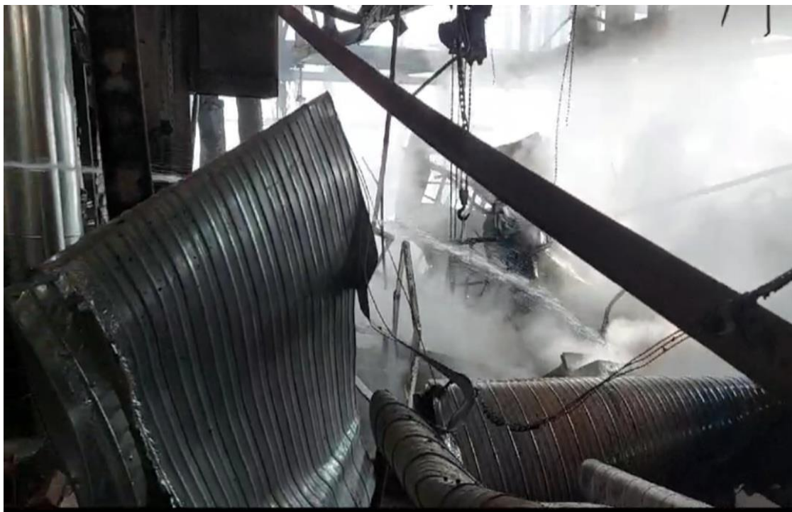
Рис.4. Состояние конструкций после аварии на ООО «Шахтинский полиэфирный завод» (Фото авторское, источник: МЧС России)
