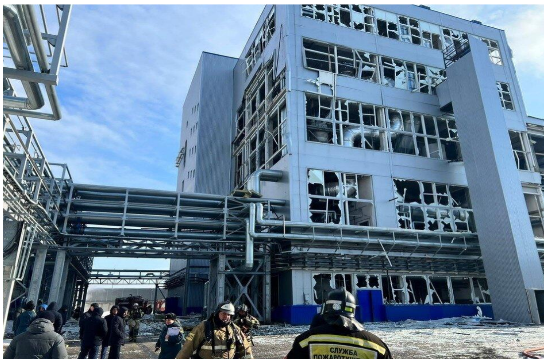
Рис.3. Общий вид последствий взрыва в производственном корпусе ООО «Шахтинский полиэфирный завод» (Фото авторское, источник: МЧС России)
