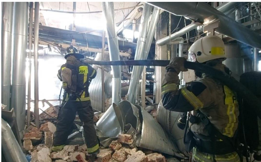
Рис.5. Состояние конструкций после аварии на ООО «Шахтинский полиэфирный завод» (Фото авторское, источник: МЧС России)
