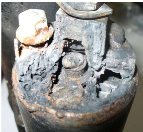
Рис.4. Оплавление штока вытягивающего реле вследствие облома возвращающей пружины
